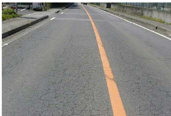
写真 1.3 総点検実施要領（参考資料）添付写真 [ひび割れ率 50%程度以上]
