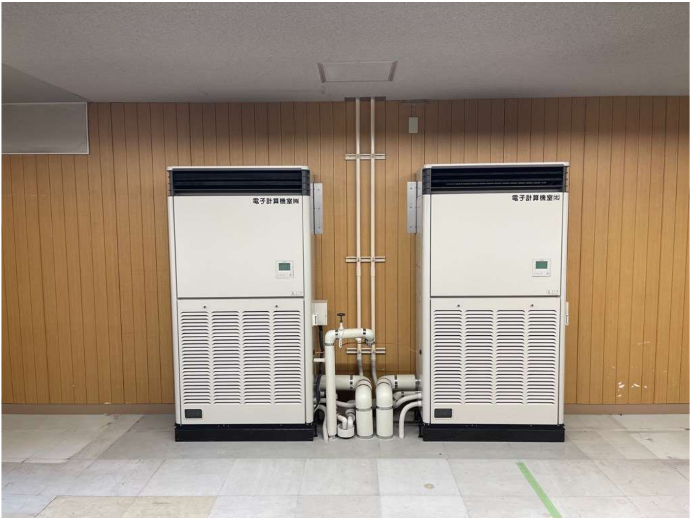
現地（旧大型電算機室）写真 室内機 全景
