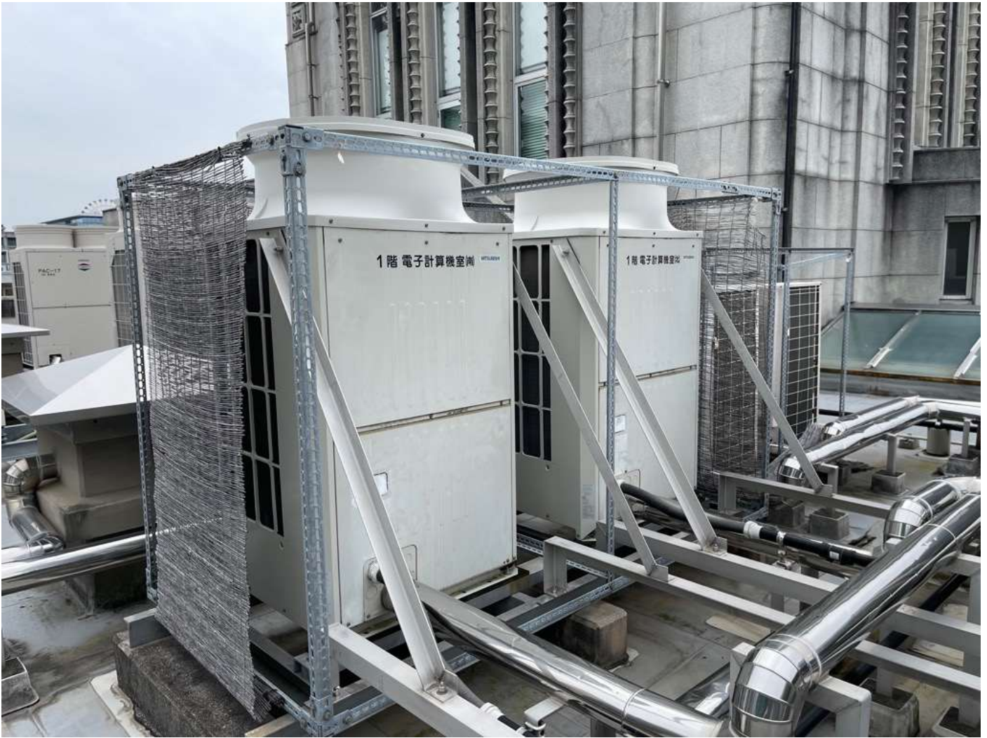
室外機（本館屋上）写真
