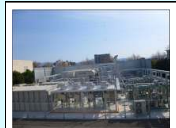
消化ガス発電設備全景
