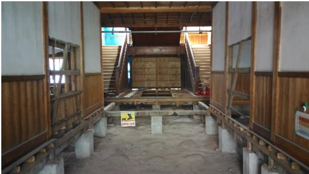
床板をはがした正面玄関付近
