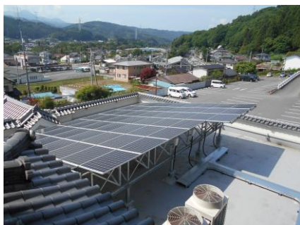
新庁舎 1 階設置の太陽光パネル
