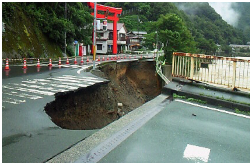
被災箇所 ⑤ 大洲市 路肩崩落
