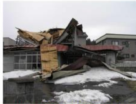
積雪により屋根が落下した空き家
