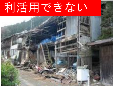
倒壊のおそれのある空き家
