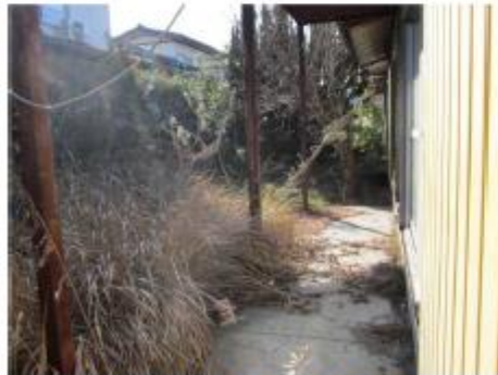
雑草が繁茂した空き家
