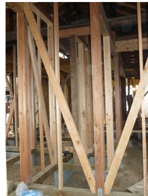
筋かいによる補強 ・基礎、土台の新設 ・老朽化した柱の取替え
