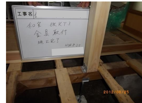
金物による補強
