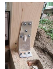
(金物による補強)
