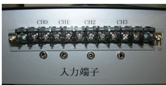
写真7 出力装置の入力端子
