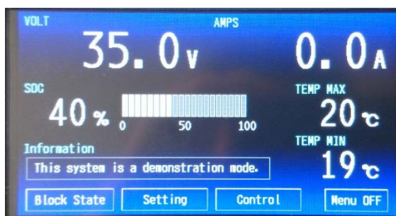
BMSモニターシステム 総合管理画面
