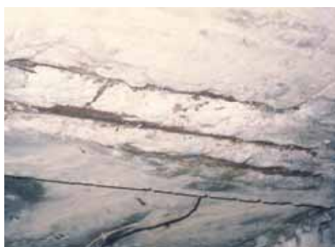
橋梁床板の鉄筋腐食
