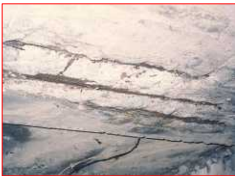
橋梁床板の鉄筋腐食
