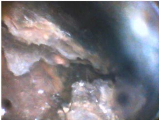
地覆内部で滞水を確認：主桁側面腐食状況
