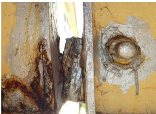
フックの溶接の状態（接合部）
