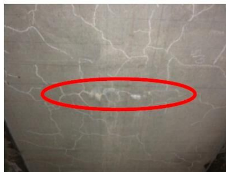
貫通ひびわれあり
