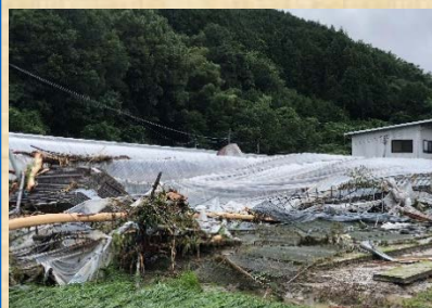
倒壊したビニールハウス
