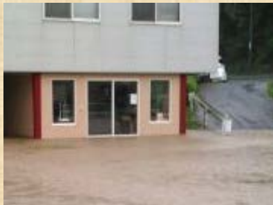
浸水した店舗部分
