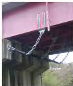
落橋防止装置(緩衝チェーン)
