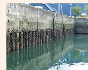
老朽化した港湾施設
