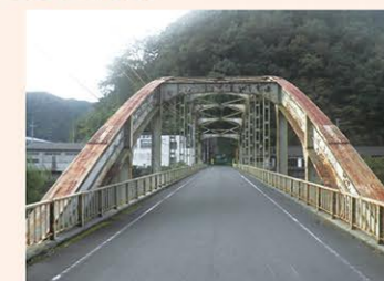
老朽化の進行した橋梁
