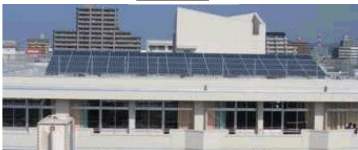
(松山市: 小学校への太陽光発電システムの設置)
