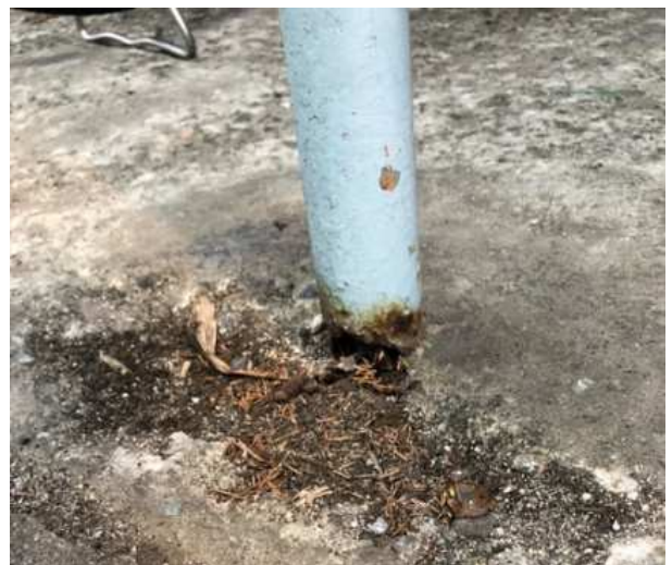
外灯接地部の腐食
