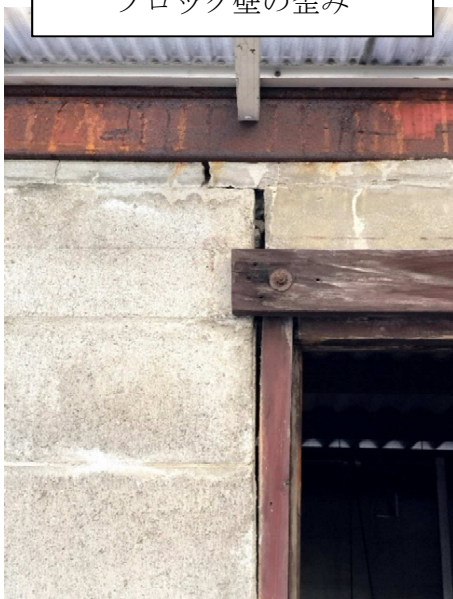
ブロック壁の歪み
