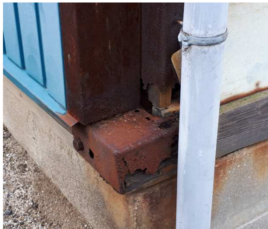
躯体の損傷が激しい建物
