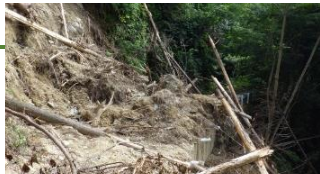
山腹・林道崩壊の様子 (出典：県林業政策課)
