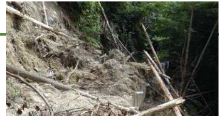
山腹・林道崩壊の様子 (出典：県林業政策課)
