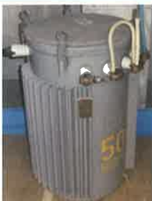
トランス(変圧器)
