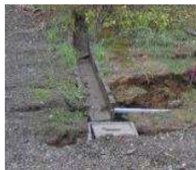
排水施設の変状
