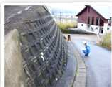
①被害状況確認(擁壁)
