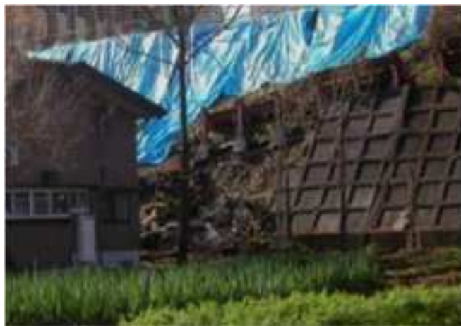
のり面保護工の変状
