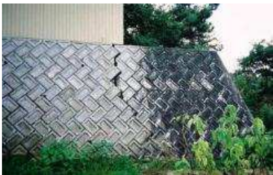
練積みのクラック
