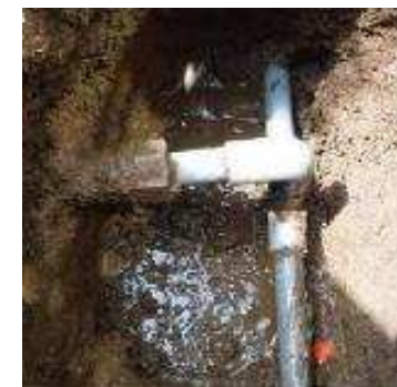
擁壁背面の水道管の破裂
