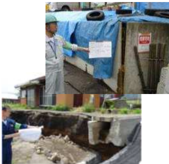
被災宅地危険度判定活動
