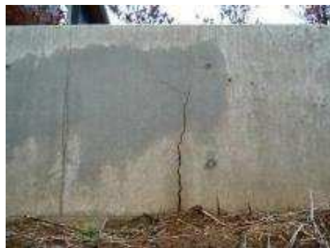
コンクリート擁壁のクラック
