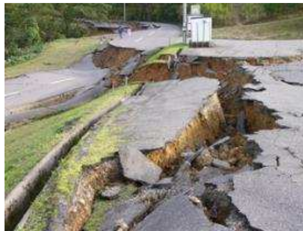
排水施設の変状
