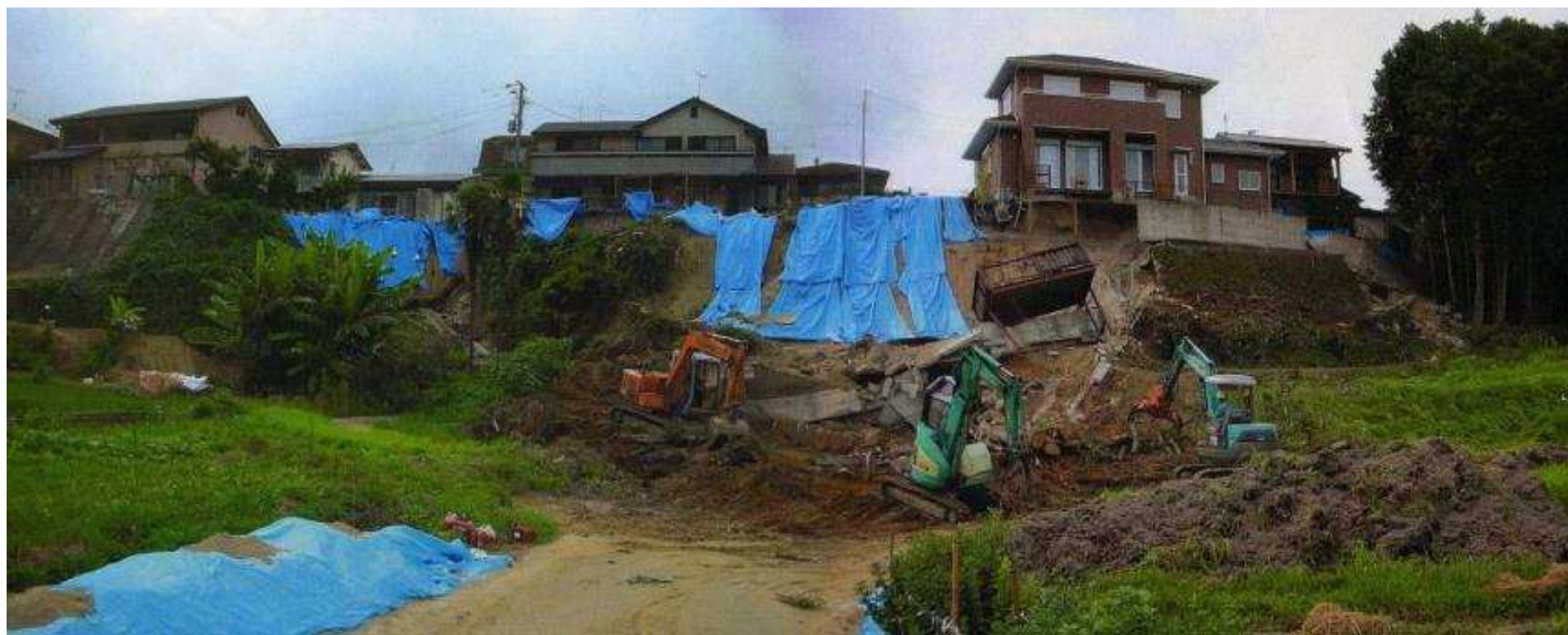
H21中国・九州北部豪雨の擁壁群の崩壊
