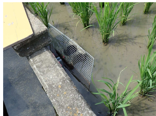
写真 金網による侵入防止
