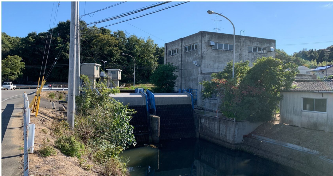
写真 6.1. 老朽化した桜井河口排水ポンプ場
