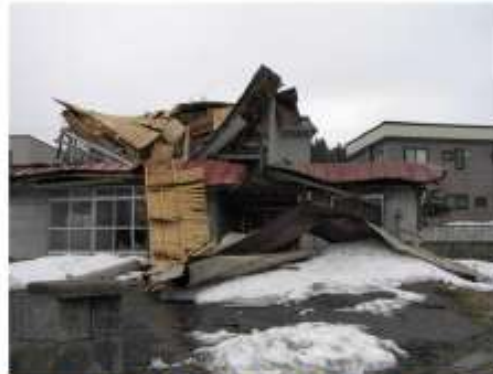
積雪により屋根が落下した空き家
