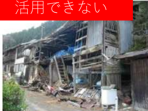
倒壊のおそれのある空き家
