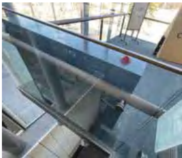
4～6. 手摺のガラスフィルムが剥がれ
