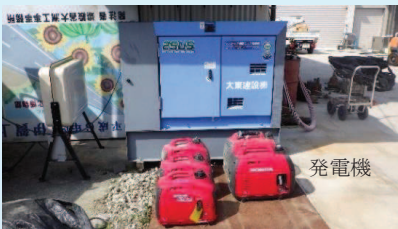
↑ 非常用電源の写真
