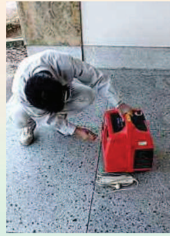
↑非常用電源の写真
