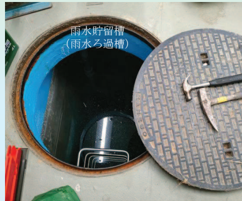
↑雨水貯留槽（雨水ろ過槽）の写真
