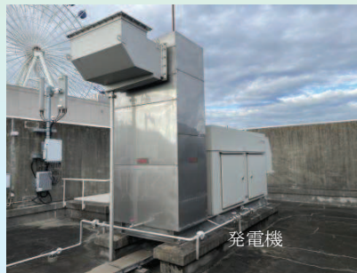
↑非常用電源の写真
