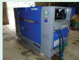
↑非常電源の写真
