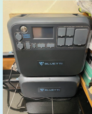
↑非常用電源の写真
