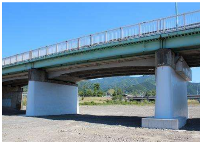
【施工事例（橋梁耐震補強）】一般県道 松山川内線（東温市） 〔橋脚巻立工〕
