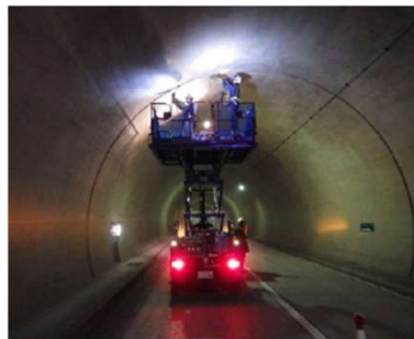
【トンネル定期点検(地芳トンネル)】 一般国道440号(久万高原町)
