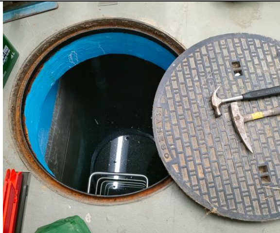
本社敷地内の雨水貯留槽：ろ過槽 （日常の庭木への散水や非常用設備として活用）
