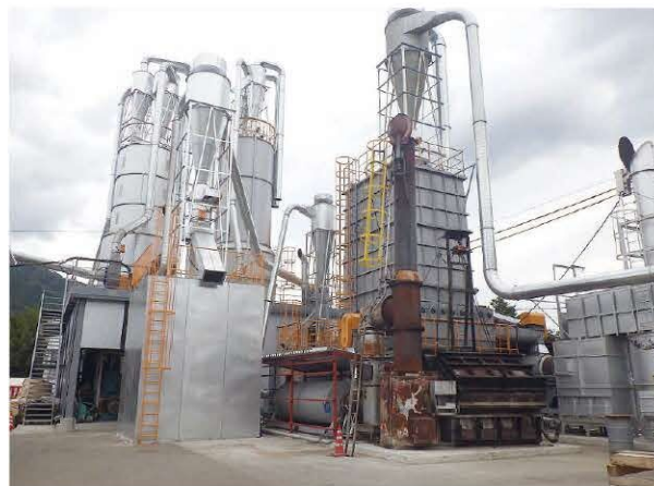
木質バイオマス発電所
