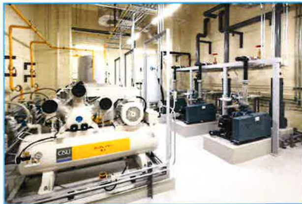
医療ガス 機械室
