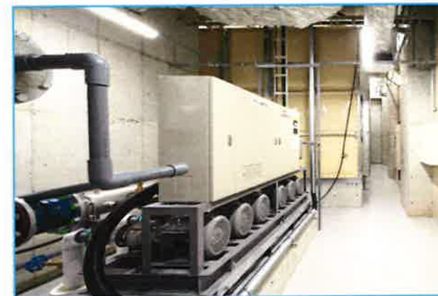
受水槽室 加圧給水ポンプ ユニット
