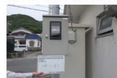
3.No.2マンホールポンプ場引込開閉器盤
