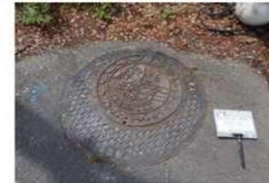
②中継ポンプ施設網代②全景
