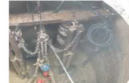
9. No.2マンホールポンプ場No.2ポンプ
