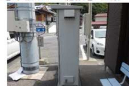
②中継ポンプ施設① 全景
