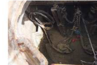
8. No.2マンホールポンプ場No.1ポンプ
