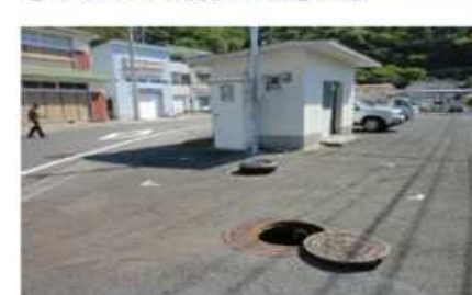
②中継ポンプ施設平瀬②全景
