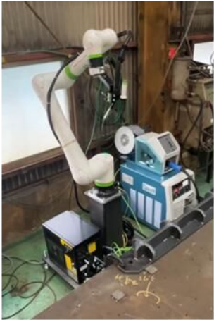
溶接ロボット
