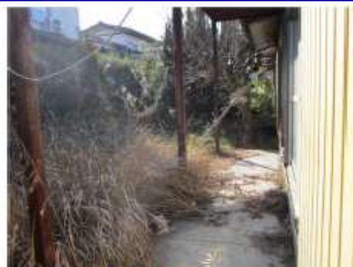
雑草が繁茂した空き家
