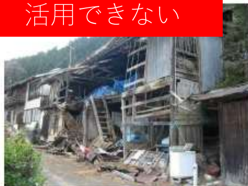
倒壊のおそれのある空き家
