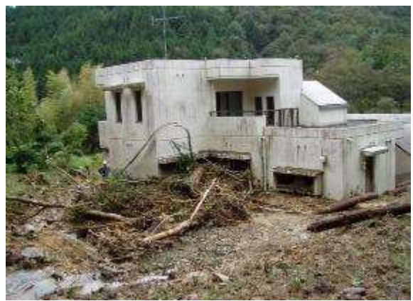
H16 台風第12号 土石流（四国中央市）
