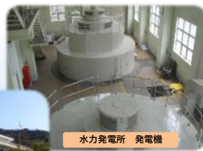
水力発電所 発電機
