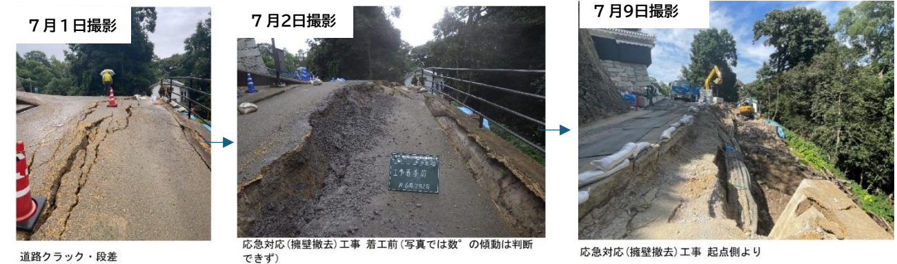
写真 2.4-1 2024/6/12~2024/7/2 間の A 箇所の路面クラックの変化
