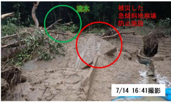
写真1-3 急傾斜地崩壊防止施設の被災状況
