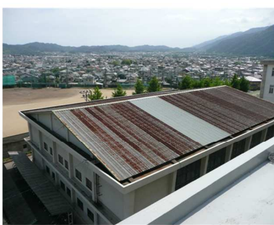
体育館屋根。全体に発錆が見られる
