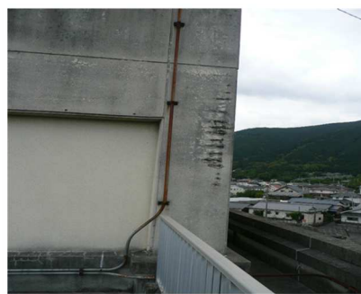
校舎外壁の爆裂
