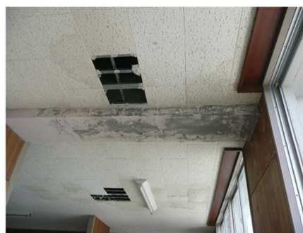
校舎の内装。雨漏りによる損傷
