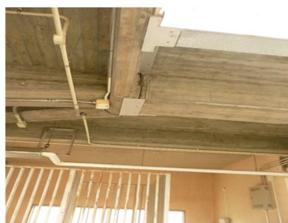
渡り廊下の外壁 金物の変形、たわみ、脱落が見られる
