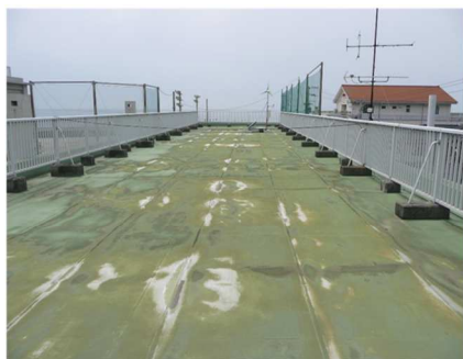
校舎屋上。防水シートの膨れ、破断（雨漏り等の原因となる）
