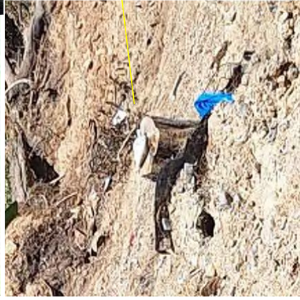
被災後 7 月 25 日撮影 (土嚢の位置は変わらず)
