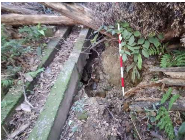
写真 3-15 水路工脇の湧水状況 水路工の底面が洗掘され、湧水が染み出し程度に認められる
