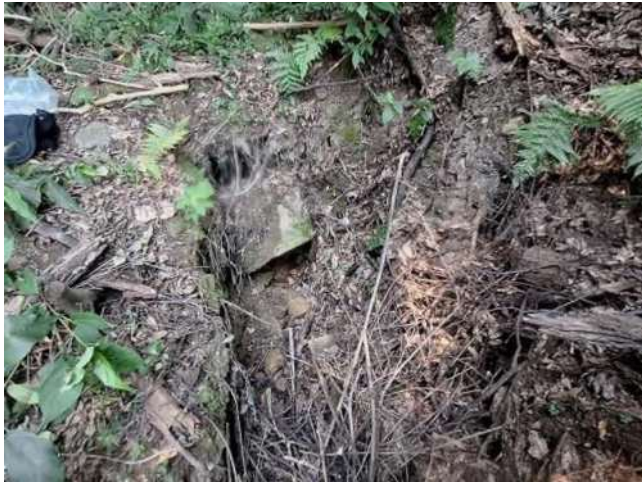
写真 3-7 湧水源頭部 侵食崩壊 幅 1.0m、深さ 1.0m 降雨時はこのあたりから湧水が発生すると推定される
