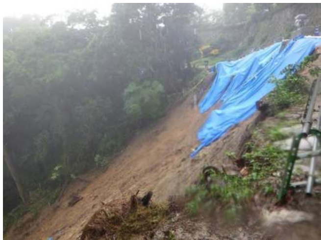
図 2-16 緊急車両用道路上の表流水状況（ブルーシート表層からの流水は少ない）
