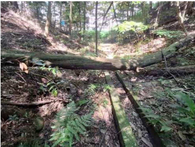
写真 3-21 水路工の状況 内部に土砂や落ち葉等が堆積している 流水は認められない
