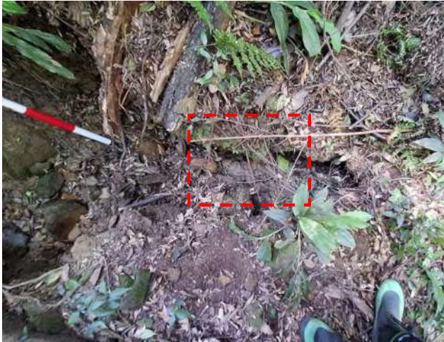
写真 3-18 ガリー洗堀箇所（写真 3-17 の下流側） 表面が湿っている状況 （赤破線で囲った範囲は熱赤外線サーモカメラで測定）
