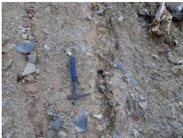
図 2-20 ガリー内に見られるパイピングホール 標高 105m 程度、大きさφ5cm 程度 斜面は全体に乾燥しており、湧水や表流水は認められない
