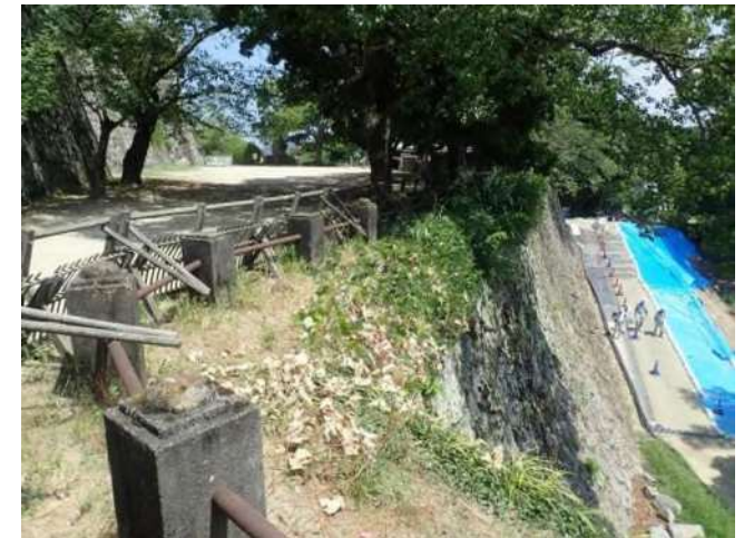
写真-11 良門南石積み屈曲箇所 この箇所は降雨時に多量の表流水が確認されている。 周辺より標高が低くなっており、表流水が集められる構造となっている。 流下痕跡が明瞭に残る。一ノ門櫓南側スロープの側溝内表流水はこの箇所に流れ込むと考えられる。
