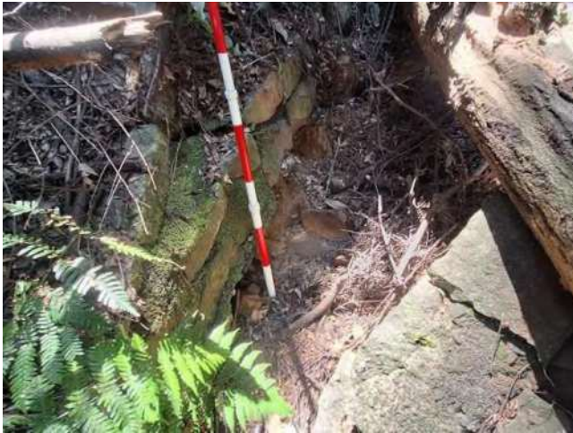
写真 3-12 水路工脇の湧水状況 溜り水が確認される
