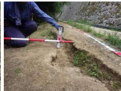
写真3 段差10cm。クラック内に草が繁茂している。
