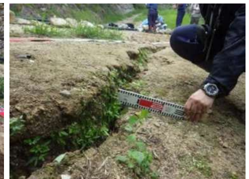
写真4 段差12cm・開きW4cm・深さD26cm。 クラック内に草が繁茂している。
