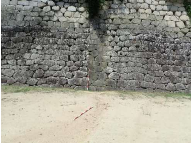
写真-4 天神櫓南下の石垣に認められる流水跡 石積みの直下の地表にも流水跡が確認される。
