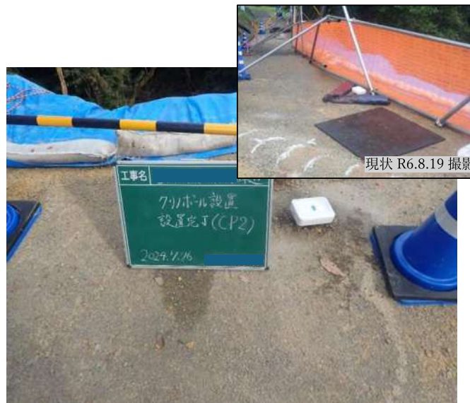
写真4 クリノボール CP2 設置状況
