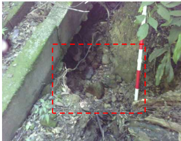
写真 3-16 水路工脇の湧水状況 表面が湿っている状況 (赤破線で囲った範囲は熱赤外線サーモカメラで測定)
