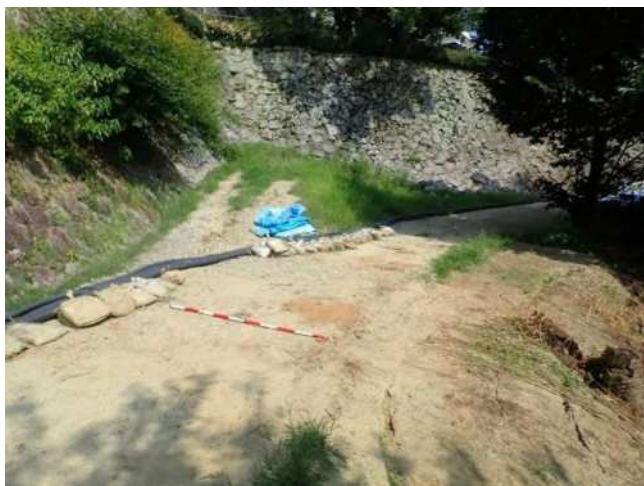
写真-16 緊急車両用道路を横断する流水痕跡 表流水はB箇所（ブルーシート）の方向へ流れる。
