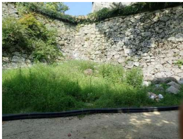
写真-17 良門南石積み屈曲箇所 この屈曲箇所は降雨時に多量の表流水が確認されている。 石積みの直下はマウンド状に土砂が積まれており、表流水の大半は南東側の石垣に沿って流れる（痕跡あり）。
