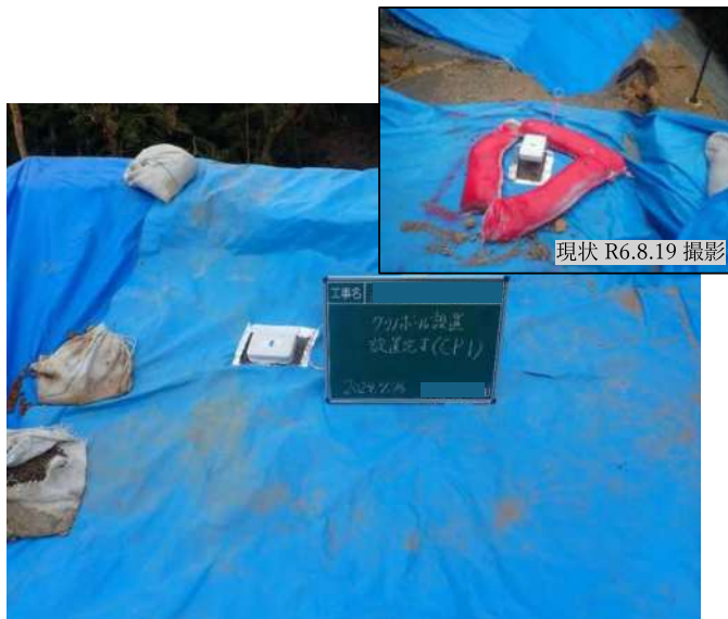
写真3 クリノボール CP1 設置状況
