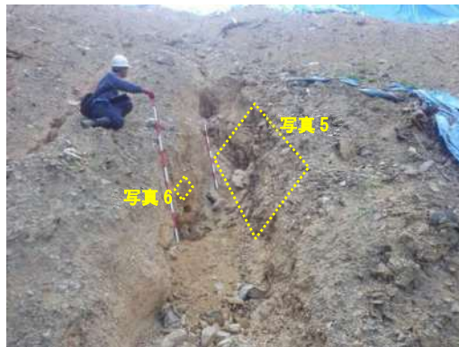
写真4 ガリー侵食の状況。深さ1.5m程度。底盤に礫岩が分布する。
