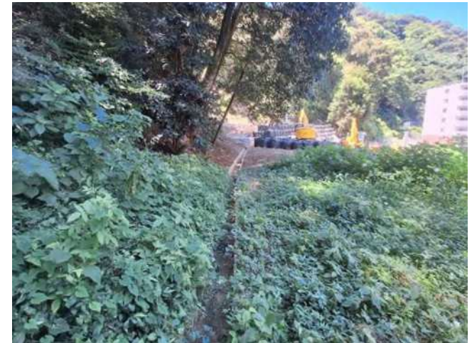
写真 3-23 水路工は西に折れて土砂流出斜面側へ連続する 水路工内に流水はなし
