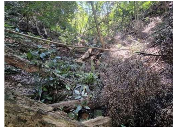
写真 3-20 谷地形の荒廃状況 水路工の上に倒木が乱雑に覆っている
