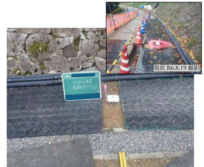
写真5 クリノボール CP3 設置状況
