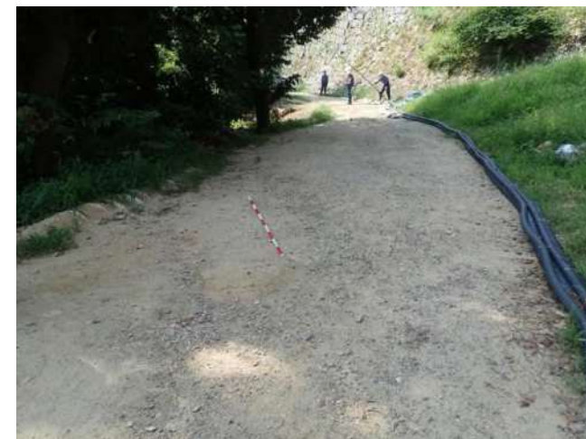
写真-15 緊急車両用道路を横断する流水痕跡 表流水は道路を横断してB箇所（ブルーシート箇所）の方向へ流れる。
