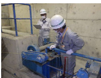
【放流設備点検】
