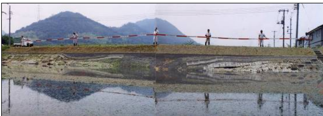
【芸予地震(H13.3.24)による堤体張りブロックの被災状況】
