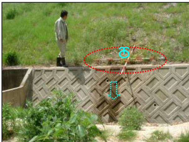
【写真③ 堤体のり尻からの漏水状況】
