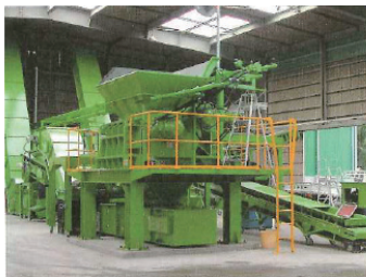
固形化燃料設備
