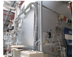
天然ガス焚きボイラ
