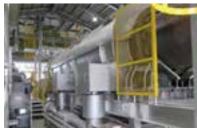
加熱改質処理装置
