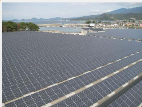
【松山太陽光発電所】
