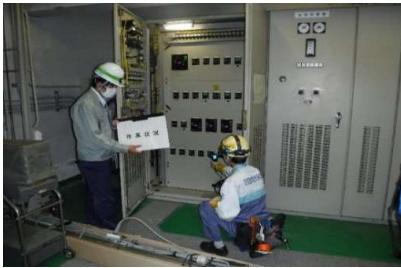
受変電設備の点検
