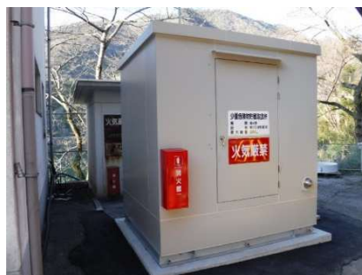
予備発電設備が72時間稼働できる量の燃料を備蓄しています。
